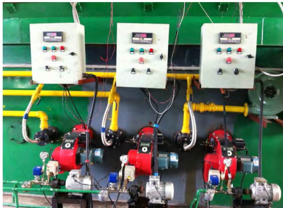
Figure 2.6, Les brûleurs de la pyrolyse alimenté par l'huile produite et par le gaz
